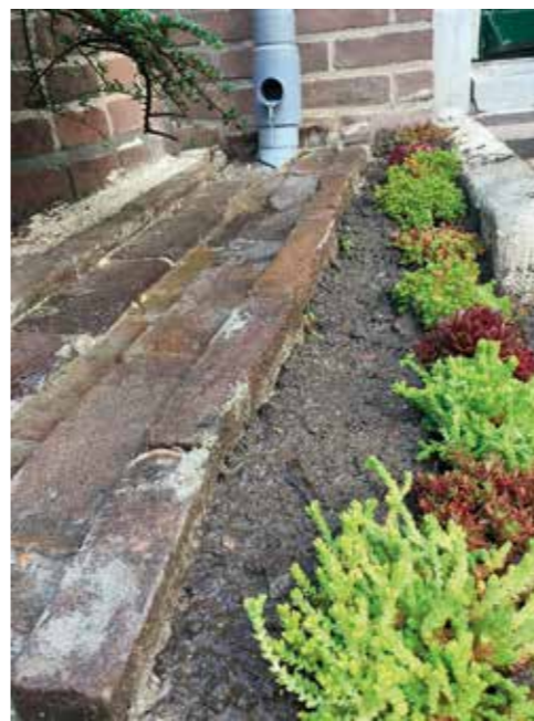
Een van het riool losgekoppelde regenpijp in Deventer.
